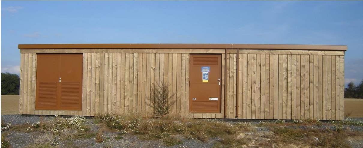
Figure 10 : Exemple de bardage bois sur un poste de livraison
